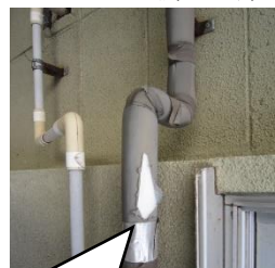
破れている状態
